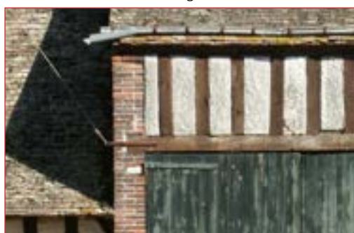
Colombages protégés par un lait de chaux.
