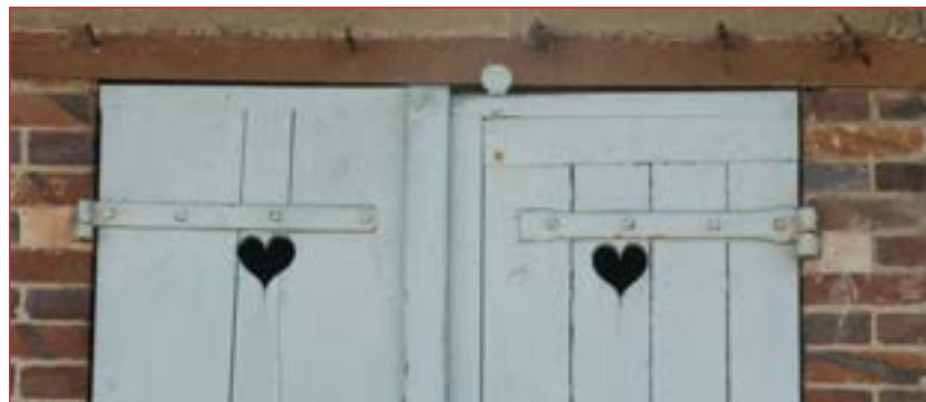
Jour de ventilation en forme de cœur
