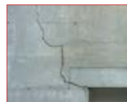
Enduit ciment sur une maçonnerie ancienne : fissurations
